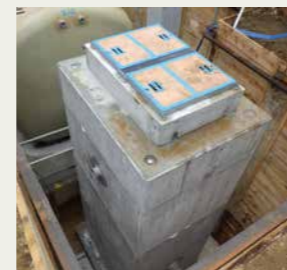
原水ポンプ槽設置例
